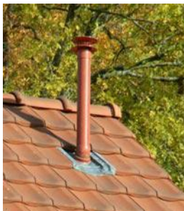
Ventilation secondaire Extracteur statique
